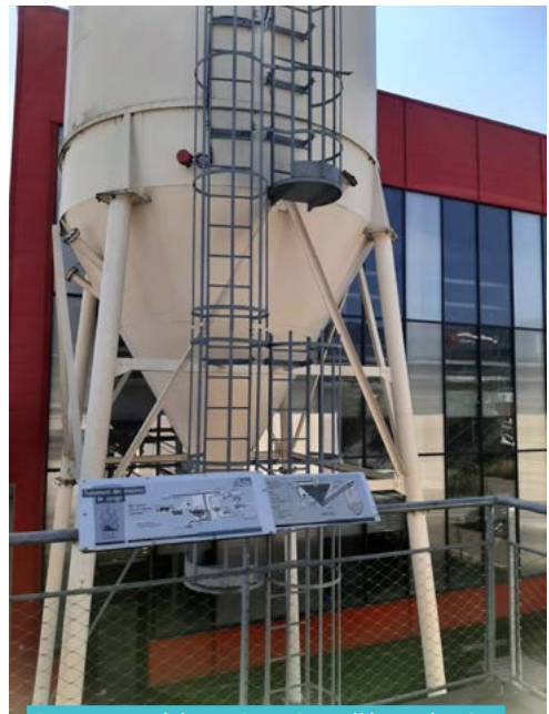
Parcours pédagogique installé sur le site de Chantabord à Chambéry du service des eaux
