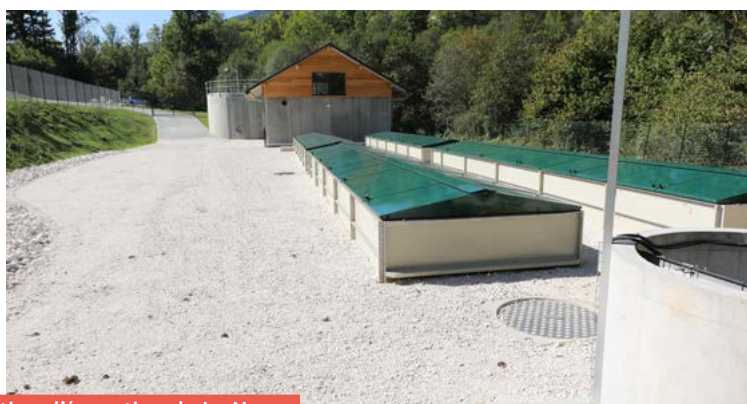
Station d'épuration de Le Noyer
