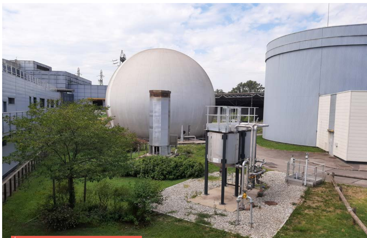
Étape de traitement du biogaz de l'UDEP
