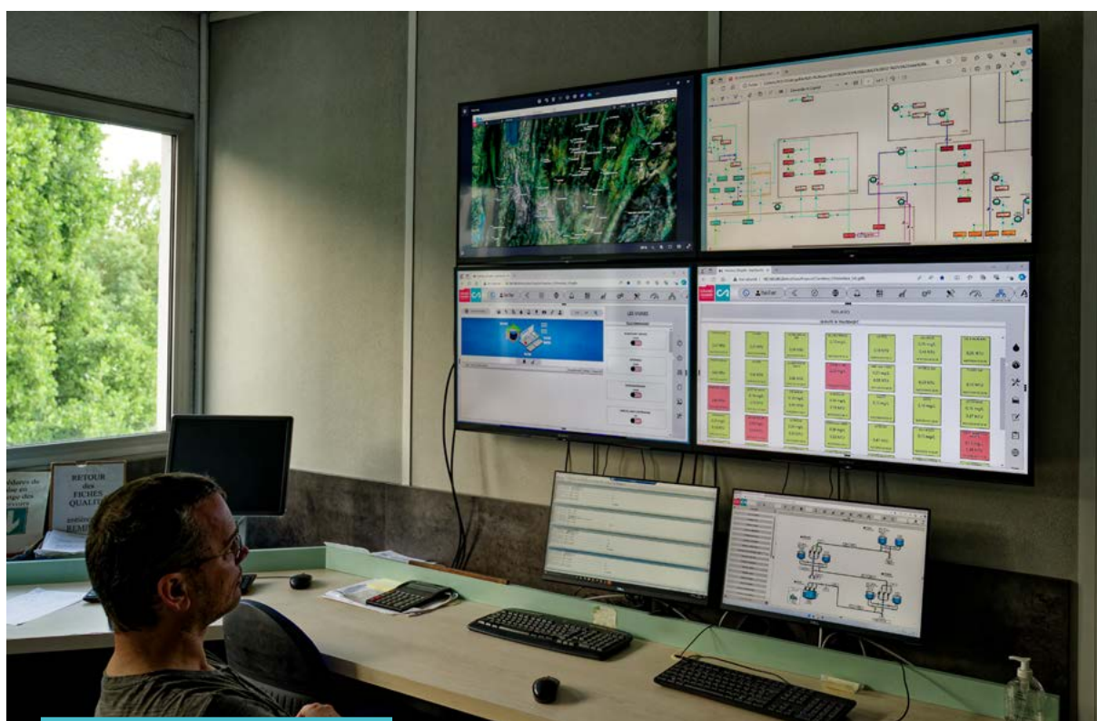
Supervision du niveau d'eau potable
