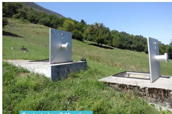
Captage Les 3 Murgiers
