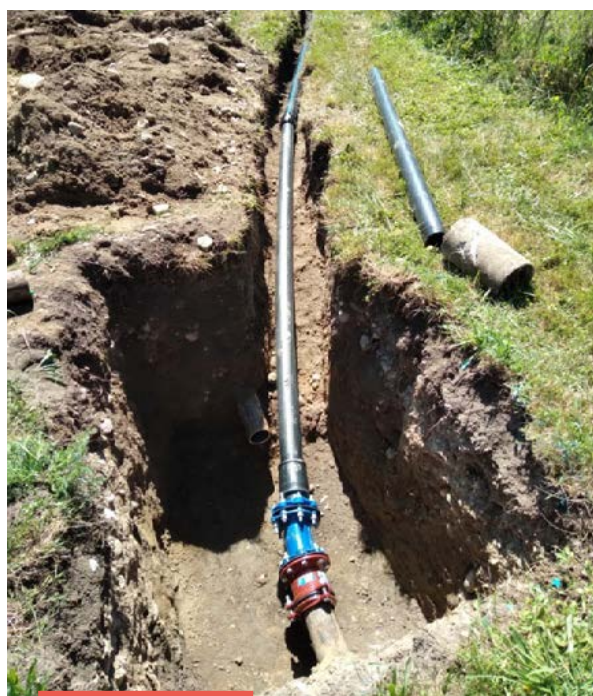
Réseau eau potable
