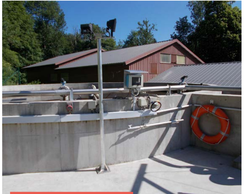
Station d'Épuration d'Aillon-le-Jeune
