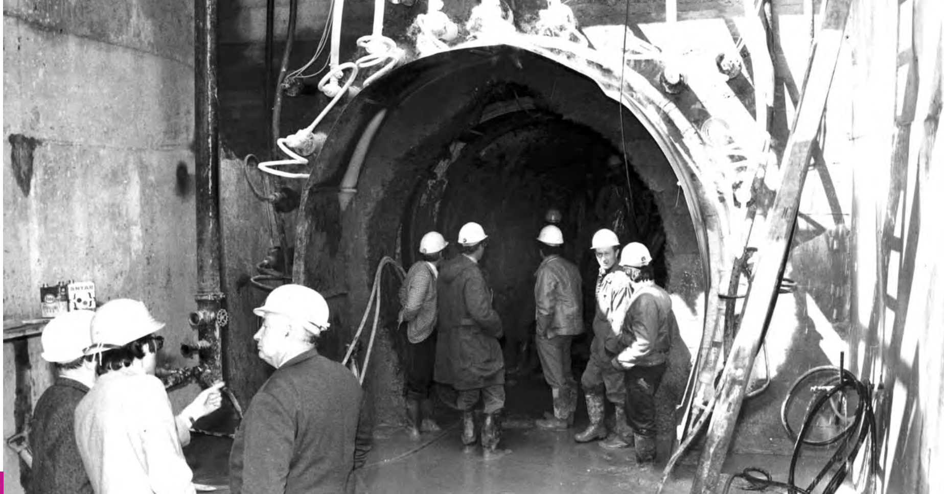
1975 Construction de la galerie de rejet des eaux épurées au Rhône : entrée au Bourget-du-Lac, congélation des 25 premiers mètres. Au premier plan A.Blin, président du SILB.
