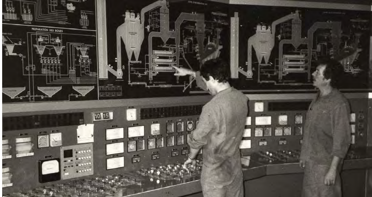
1983 Usine d'incinération des ordures à Chambéry : salle des commandes, M. Teyssier et L. Guigue
